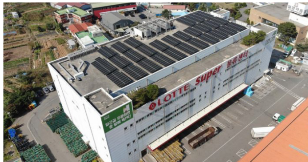
롯데슈퍼 태양광 설비
